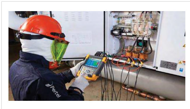
Figura 9. Método de utilización del equipo de protección en análisis de calidad de la energía.
