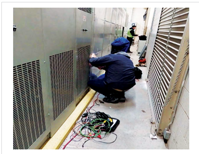
Figura 6. Apertura del lugar de conexión del equipo analizador.
