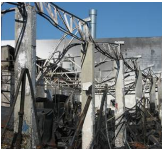
Figura 13 Deformaciones de estructura de acero
