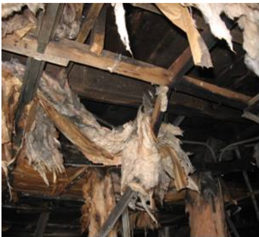
Figura 14 Daños en los plafones de la zona de oficinas
