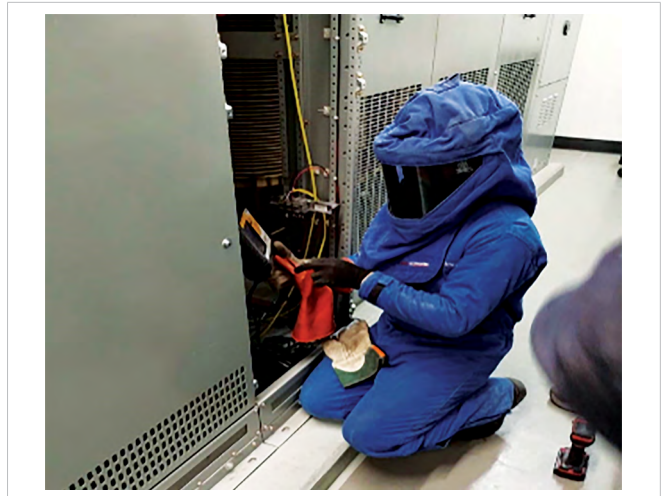
Figura 7. Inspección del equipo conectado a la red eléctrica de la industria maquiladora.
